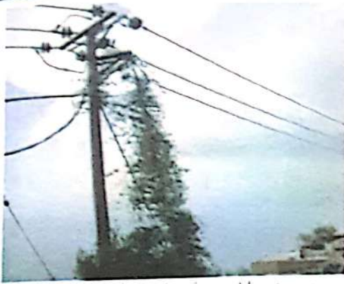
2 - الشجرة تلامس أسلاك الشبكة الكهربائية
